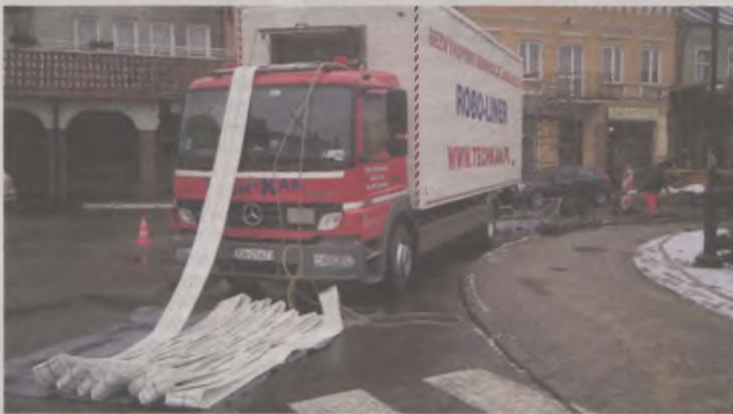
Nowoczesna metoda renowacji sieci kanalizacyjnej i deszczowej na starówce jest o 10 do 15 razy tańsza, gdyby ją wykonać tradycyjną metodą prac ziemnych.
