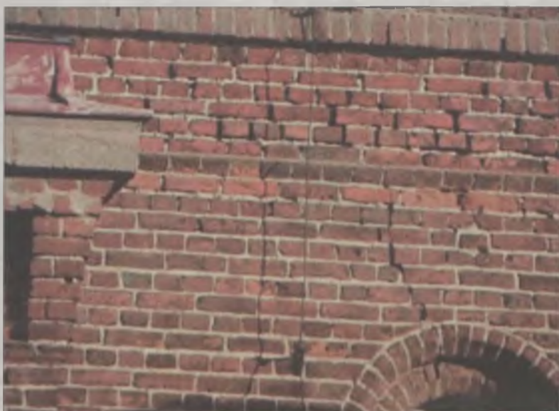
Popękane mury potrzebują szybkiej naprawy.
