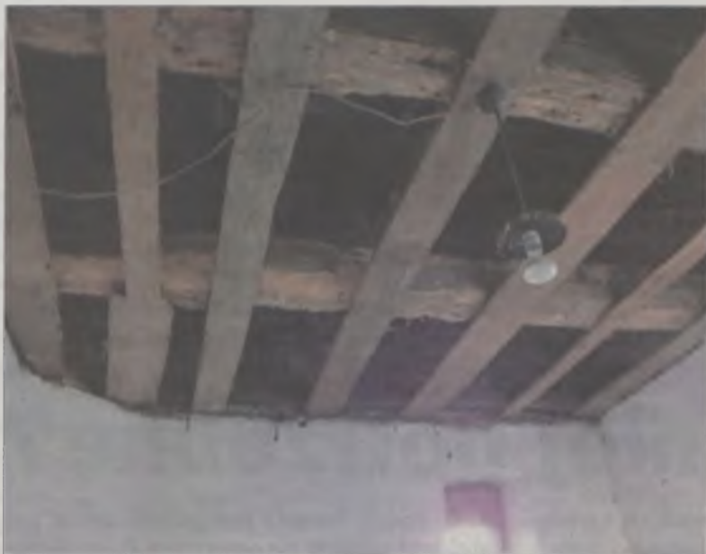
Nadgryzione przez czas i korniki, belki stropowe kościelnej wieży.
