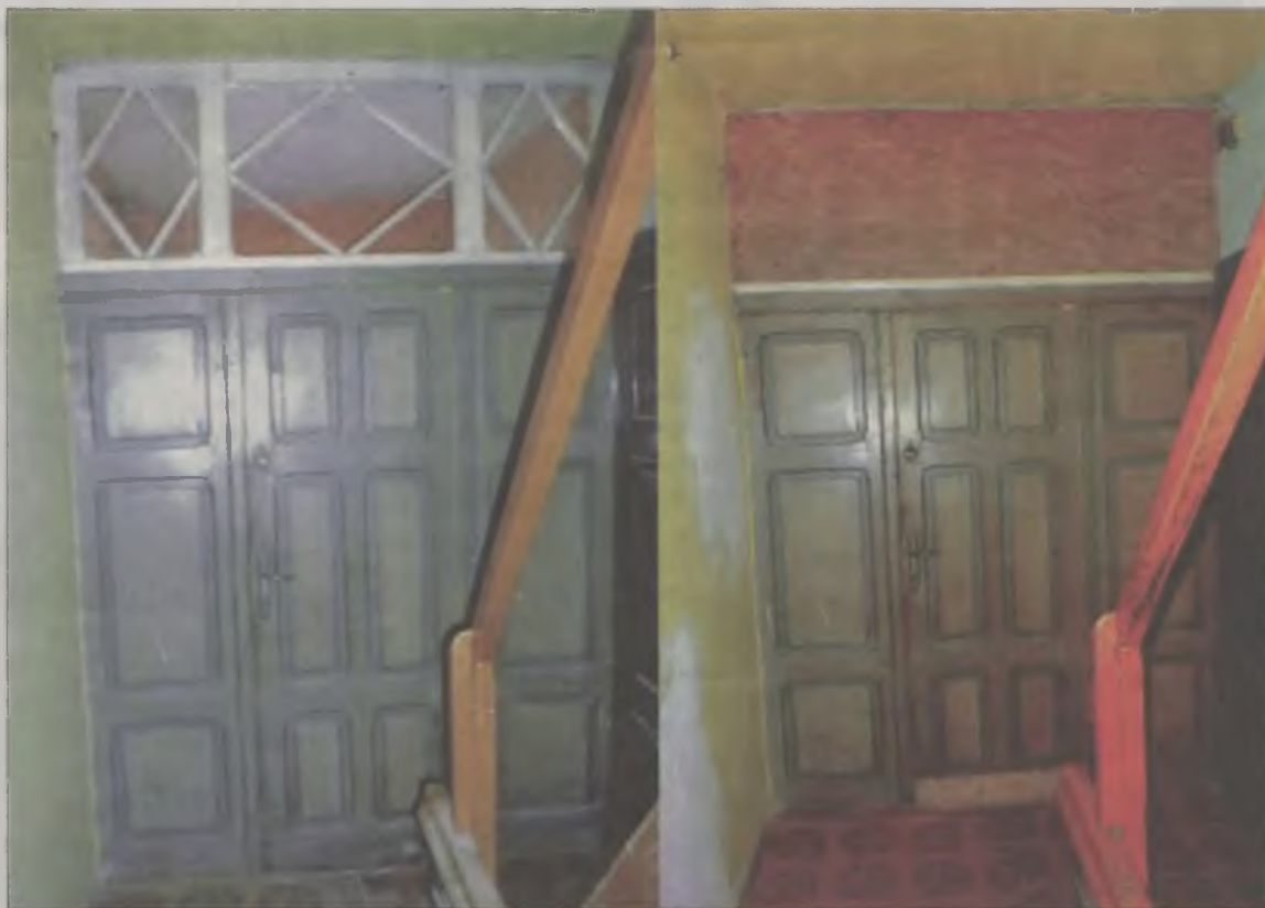
Tak wyglądało przeszklenie w drzwiach prowadzących na balkon, które nowi współwłaściciele kamienicy postanowili zamurować. Zdaniem rodzin Dębowskich i Sadysiów, nie mieli do tego prawa bez porozumienia z nimi. Korytarz jest bowiem częścią wspólną, a prace remontowe tam dokonane, tę część zmniejszyły na korzyść małżeństwa Kucharskich.
