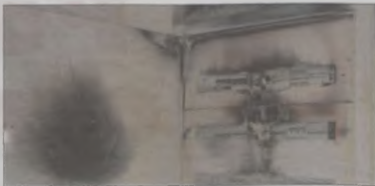
Pożar powstał w skrzynce rozdzielczej prądu.
