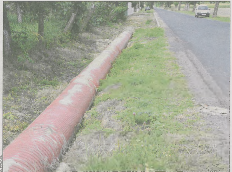
Woda odkryła zasypane rury
