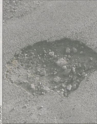
Tak wygląda miejscami nawierzchnia ul. Kopieczki
