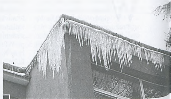
Zimą należy zwracać uwagę na zalegający na dachach śnieg oraz spadające sople
