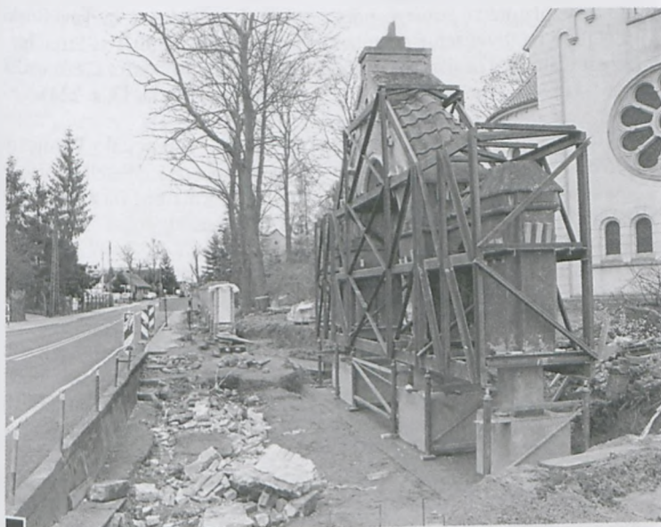
Lokalizacja przeniesionej bramy. Widać poziom jezdni, poprzednie miejsce bramy (cegłany gruz fundamentów) oraz obniżenie starego chodnika fot. Piotr P. Ruskowski
