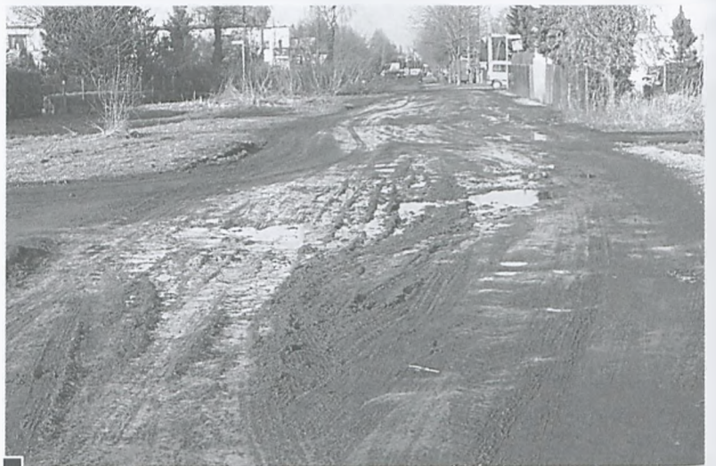
Nieutwardzony fragment ul. Morelowej pomiędzy Wojska Polskiego a gruntową w tym rejonie ul. Buczka, rozjeżdżony m.in. przez ciężki sprzęt, docierający na pobliskie place budowy nowych domów (przy ul. Buczka) fot. Hanna Siatka
