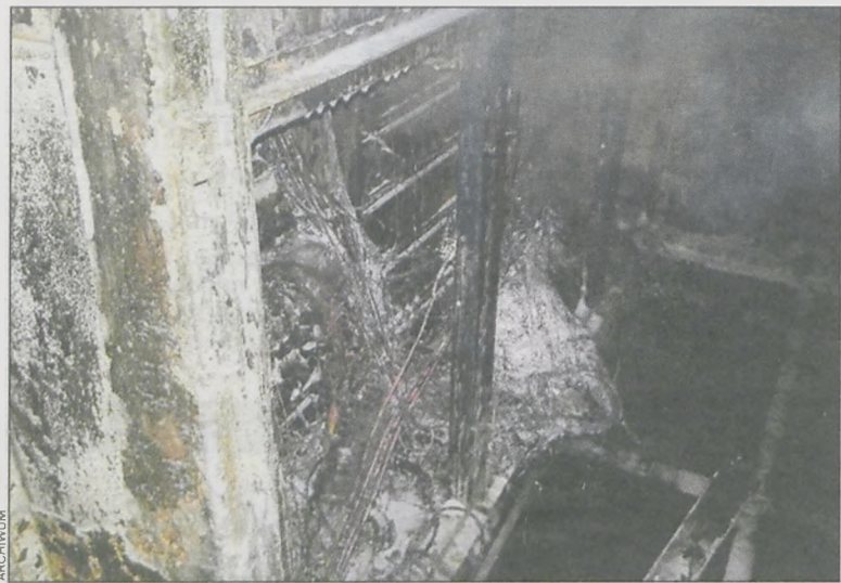
Palilo się wewnątrz sterowni na terenie zakładu betoniarskiego
