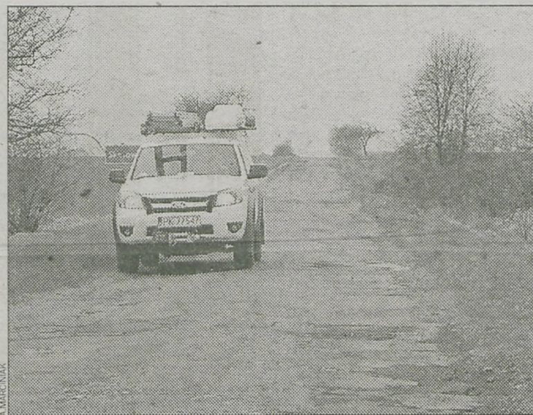
Stan tej drogi zagraża bezpieczeństwu użytkowników
