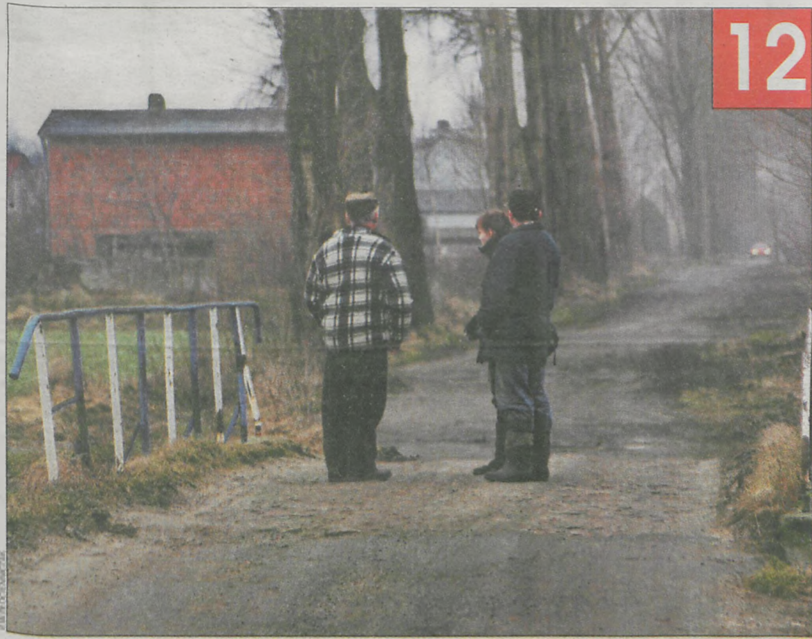
Droga polna jest pełna dziur, a most zniszczony
