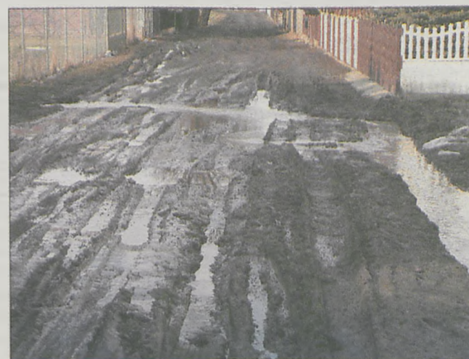
OPŁOTKI. Stan opłakany. Rwący potok
