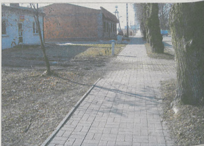
CHODNIK przy ul. Dworcowej nie wszędzie wygląda tak dobrze. O naprawę uszkodzonych odcinków apelował na ostatniej sesji sołtys Kotlina Jerzy Szymczak
