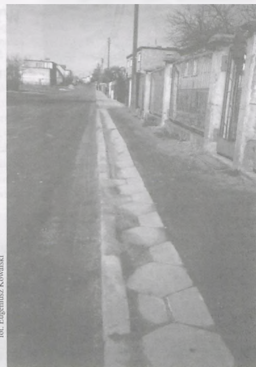
Nie ukończony chodnik na ul. Buczka
