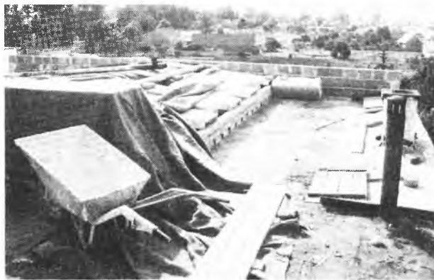
W zeszłym roku dach w szkole w Golinie naprawiał JARBUD. Teraz wymaga on ponownego remontu Fot. A. Czerneńko
