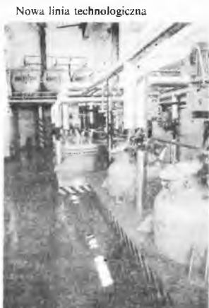
Nowa linia technologiczna
