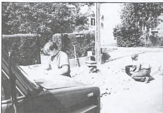
Każdy kabel na swoim miejscu
