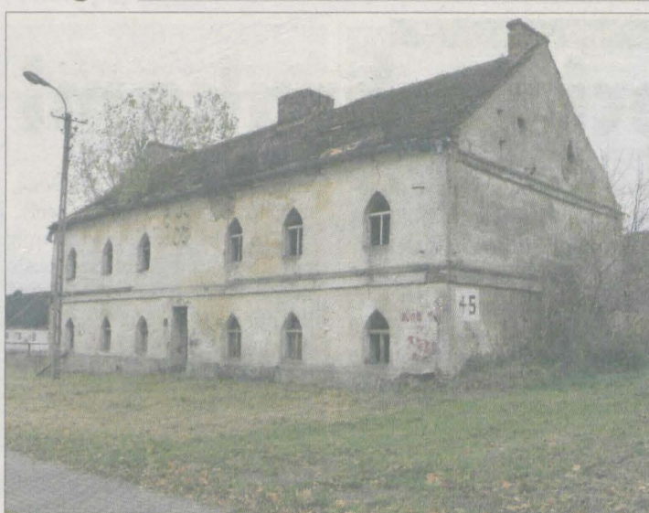
Działka została uporządkowana, ale sam obiekt przy ul. Harcerskiej musi jeszcze zostać zabezpieczony.
