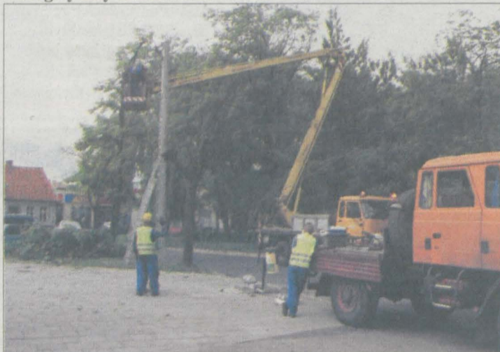
Usuwanie awarii trwało we wtorek do godzin południowych.
