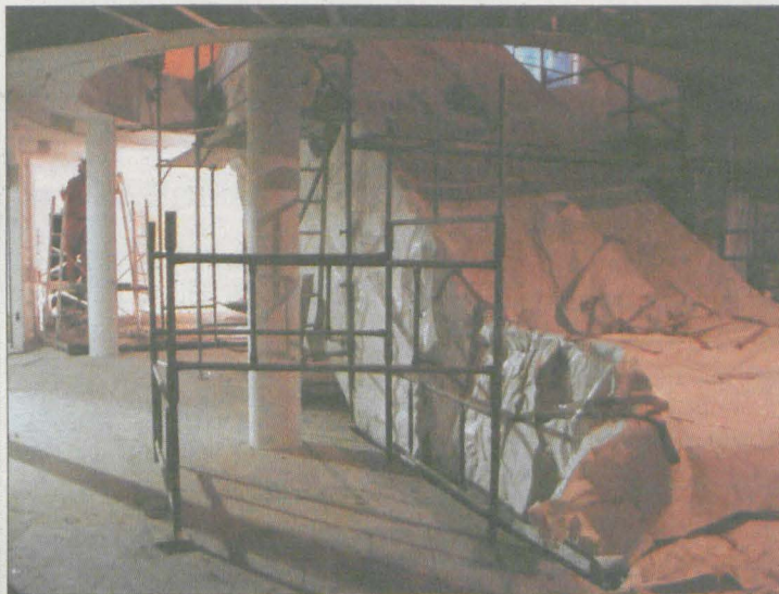
Ruchome schody, jak na razie, są „zapakowane”. Za kilka tygodni będą wozić średzian na wyższe kondygnacje.
