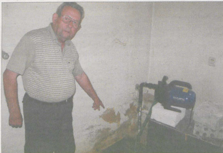
W tym miejscu mieliśmy kiedyś liczniki do wody. Zawsze było tutaj sucho. Teraz studzienkę wypełnia woda - mówi Jan Bysiak.
