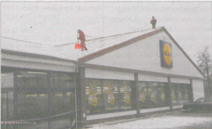
Powiatowy inspektor nadzoru budowlanego musiał monitorować Lidla, aby z dachu sklepu usunięto śnieg.
