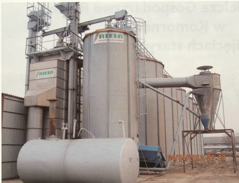
Zespół silosów na 1500 t wraz z suszarnią i czyszczalnią - Komorniki
