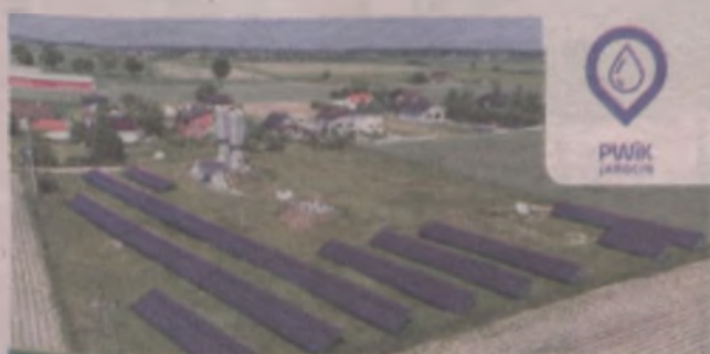
548 paneli o mocy 180 kW
