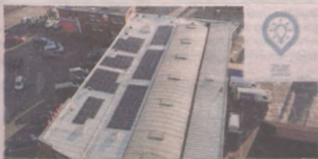
151 paneli o mocy 50 kW
