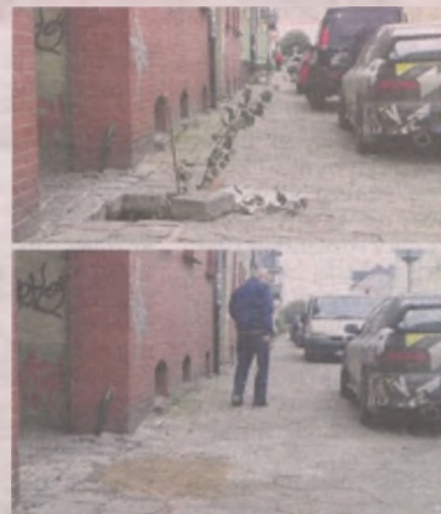
Po naszej interwencji dziura w chodniku przy ul. Dąbrowskiego została naprawiona
