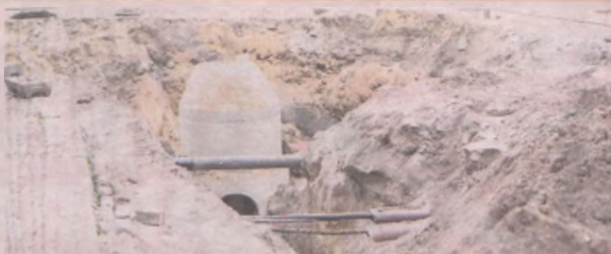
Fatalny stan rur gazowych został odkryty w czasie prac przy wymianie innych sieci podziemnych w centrum Jarocina
