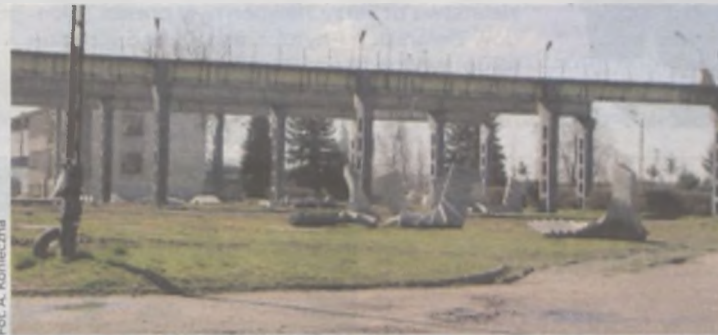
Opuszczony zakład świeci pustkami, a porzucone elementy żelbetonowych schodów widać nawet z ulicy
