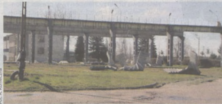
Opuszczony zakład świeci pustkami, a porzucone elementy żelbetonowych schodów widać nawet z ulicy
