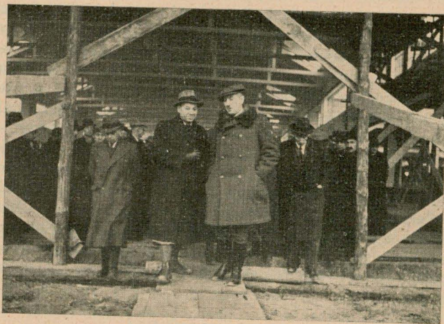
W jednej z hal fabryki w Mielcu, znajdującej się w trakcie budowy pan wicepremier Kwiatkowski w towarzystwie uczestników wycieczki publicystów do COP-u.
