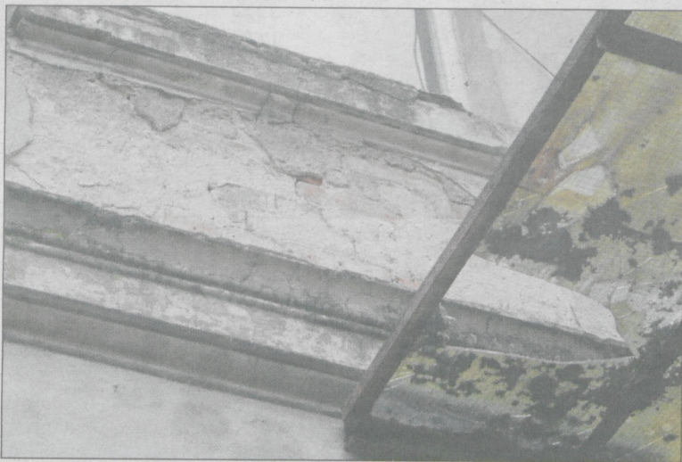
Tynk odpada z elewacji
