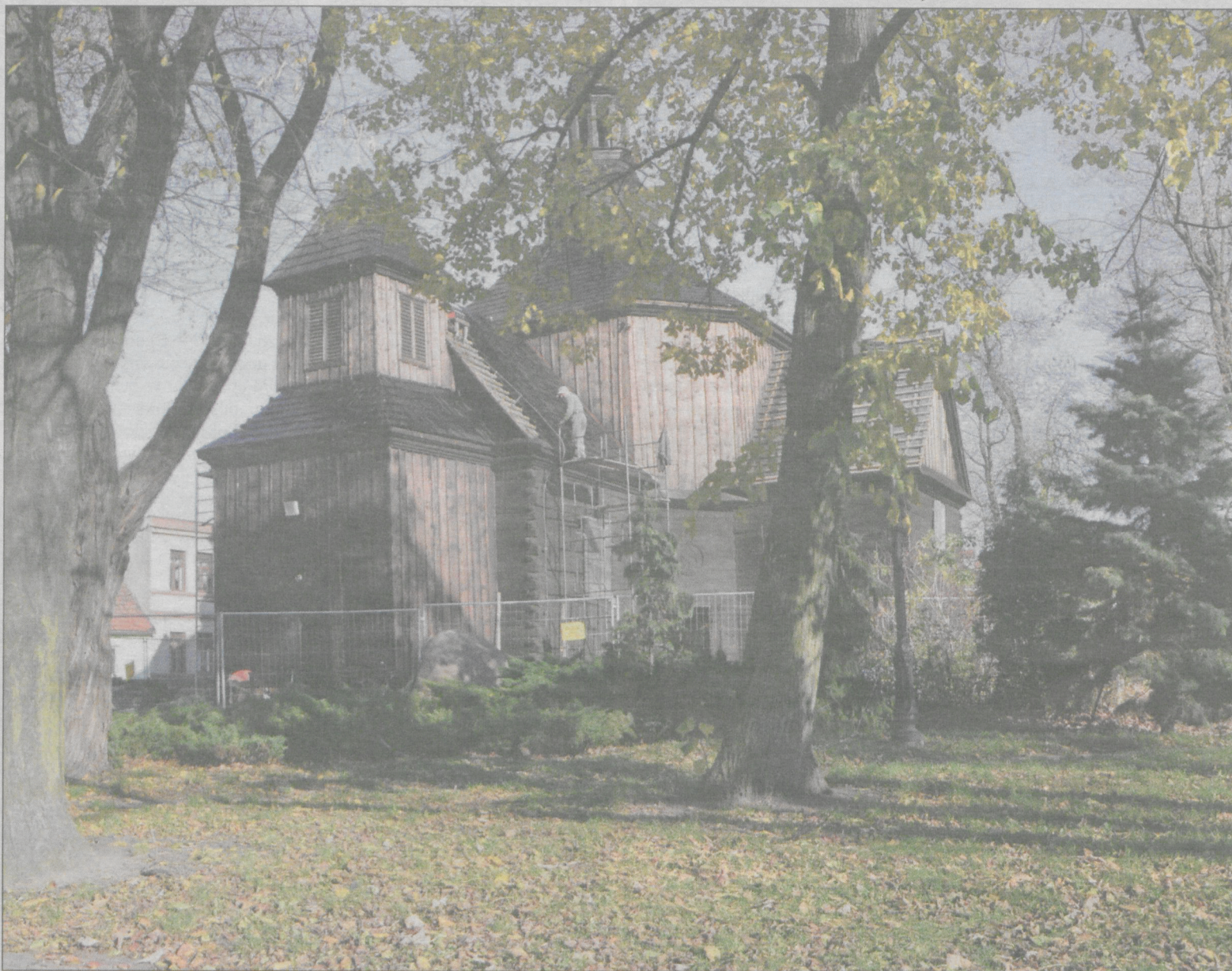
Trwają prace na dachu. Na jego części położono już zakonserwowany, dwuwarstwowy gont
