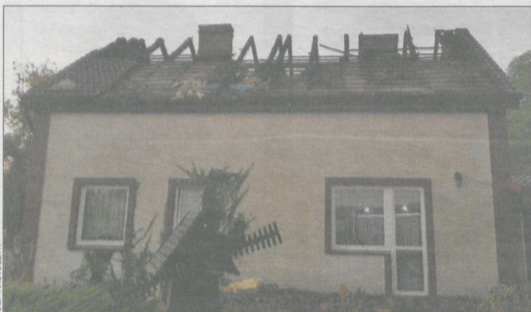
Ogień strawił dach domu
