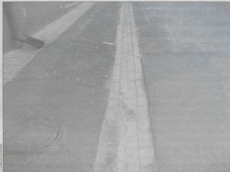
Studzienki nie odbierają wody
