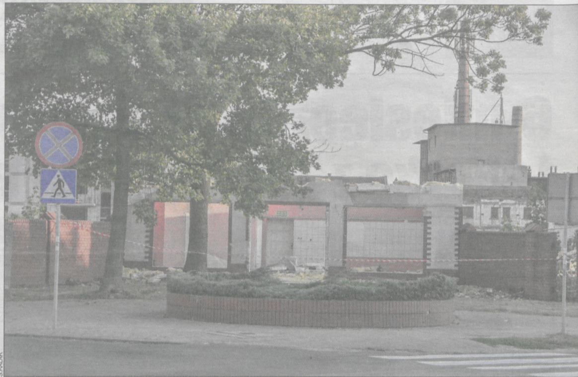
Objekt budowany jest bardzo szybko. Pierwsi klienci mają z niego korzystać już w grudniu
