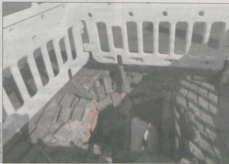
Po tym chodniku na skrzyżowaniu Polnej z Łacnową przejechał tir
