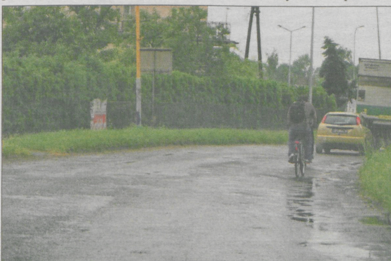
Tak nawierzchnia wyglądała na początku 2016 r.
