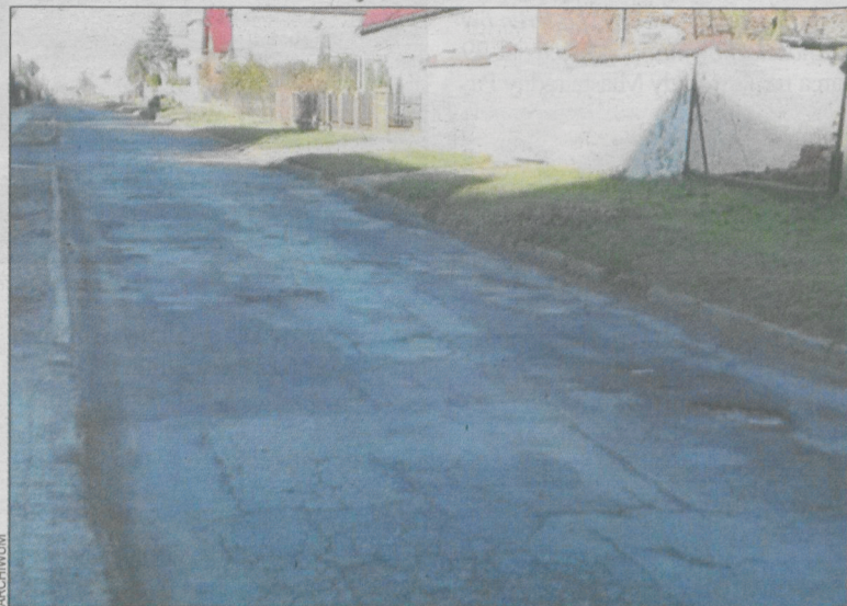
Droga wymaga od dawna gruntownej naprawy
