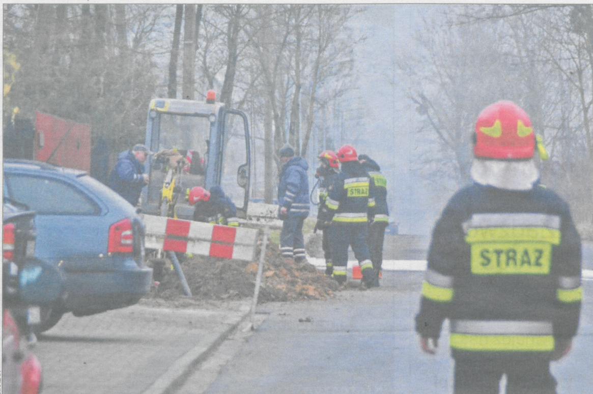
Gazociąg uszkodziła mała koparka
