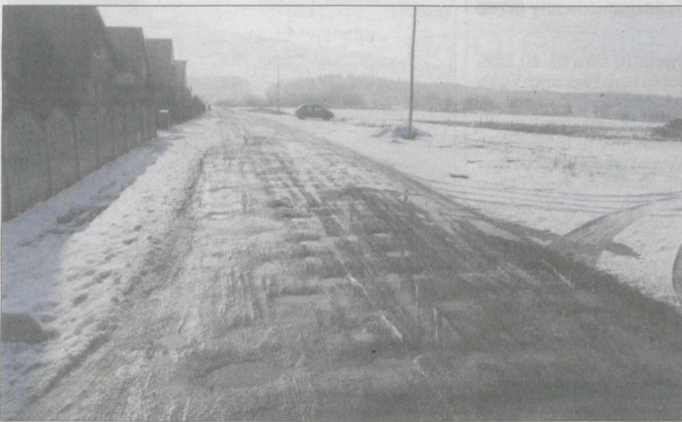
Ulica wymaga remontu
