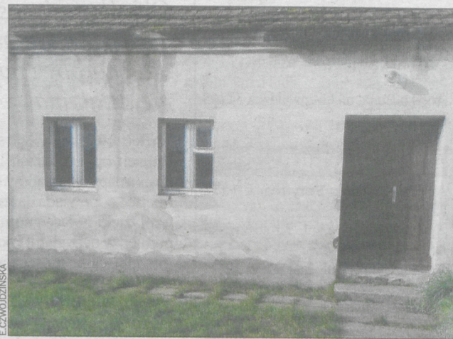
Świetlica ma dziurawy dach a zamiast WC wychodek na zewnątrz
