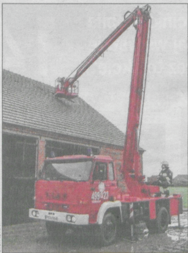
Strażacy zabezpieczali uszkodzone dachy
