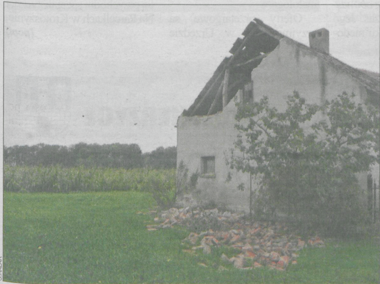
W Nowym Raciborowie uszkodziło budynek, gdzie składowano drewno
