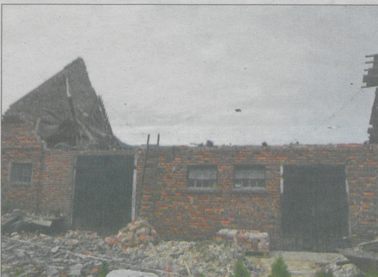
W gospodarstwie Szlachtów uszkodziło prawie cały dach
