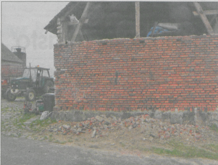
Na ul. Krzywej wyrwało część ściany szczytowej
