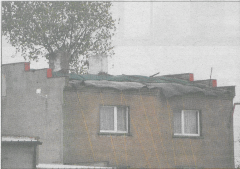
Wiatr zerwał dach tego domu w Dąbrowie
