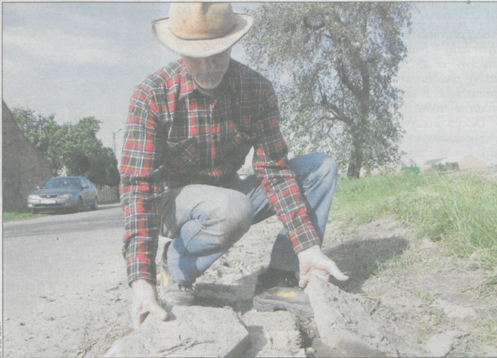
Sołtys Kubiak pokazuje popękane płyty chodnikowe na Kobierskiej
