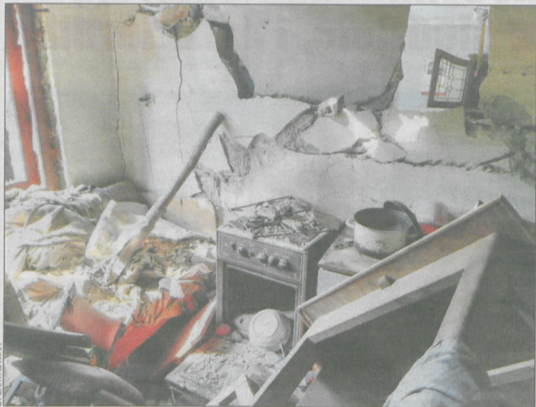
Strop i ściana nośna budynku zostały uszkodzone
