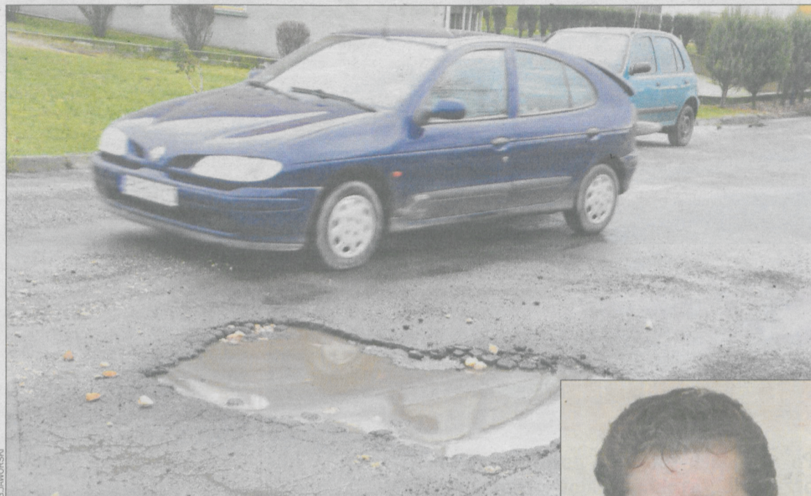
Stan ul. Klemczaka, która jest w opłakanym stanie, zmieni się po przebudowie sieci
