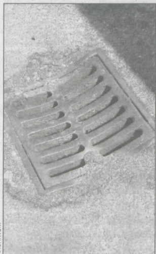
Studzienki są zapadnięte
