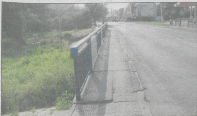
Zbyt wąskie przejście przez most
