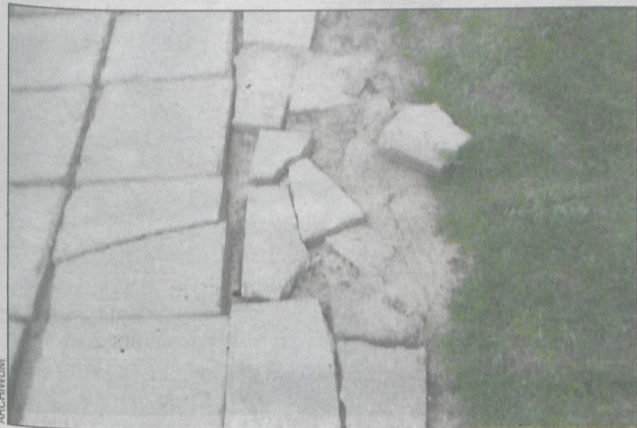
Płytki są popękane
