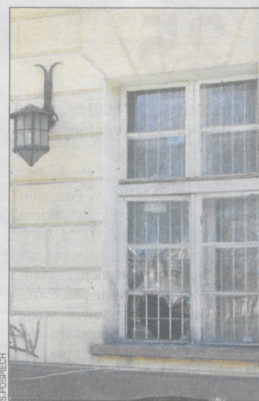
Stłuczone szyby w oknie budynku
