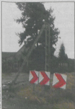
Drzewo złamało słupy energetyczne
