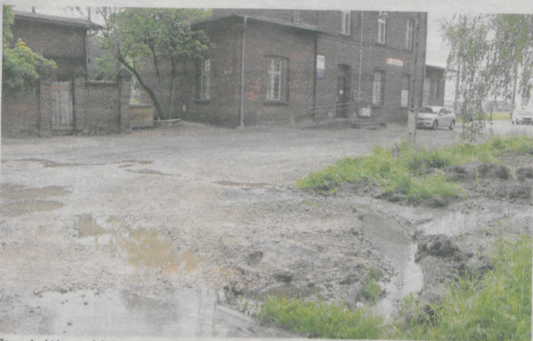
Za wodę, która wycieka przy ul. Kolejowej, PKP będzie musiało zapłacić
