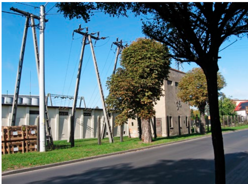
Główny Punkt Zasilania w Pleszewie przy ulicy Piaski, stan obecny.
