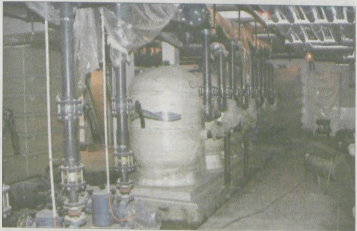
Serce basenu - pompy i filtry, które pozwolą wymienić całą wodę w basenie nawet 24 razy na dobę.
